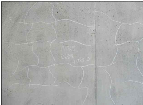
교각 기둥부 망상균열(P2)
