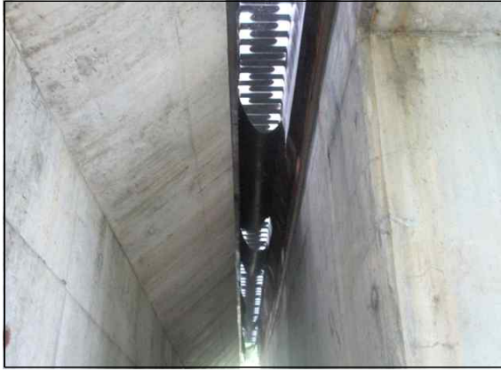
신축이음 물받이 파손(A1)
