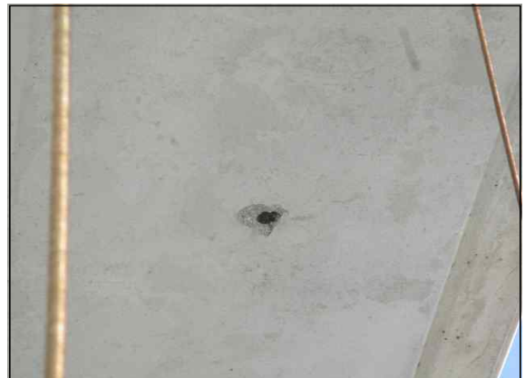
바닥판 콘크리트 파손(S13)
