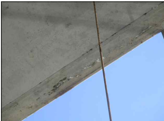
바닥판 균열부 백태(S13)
