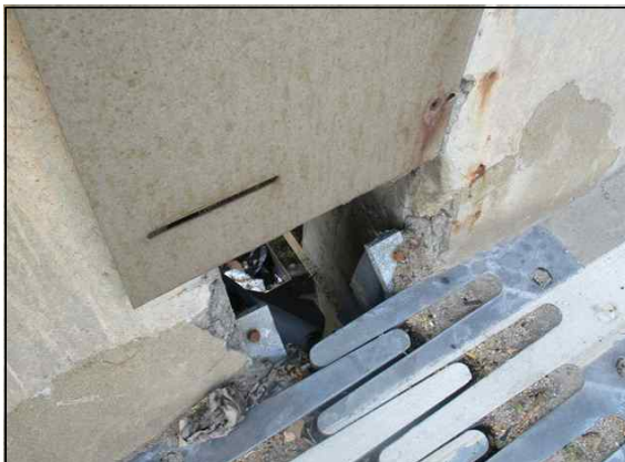
신축이음 물받치 덮개 파손(A2)
