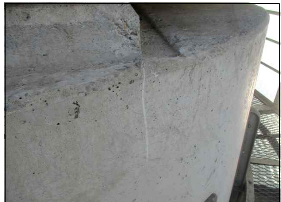
교각 기둥부 균열(P11)
