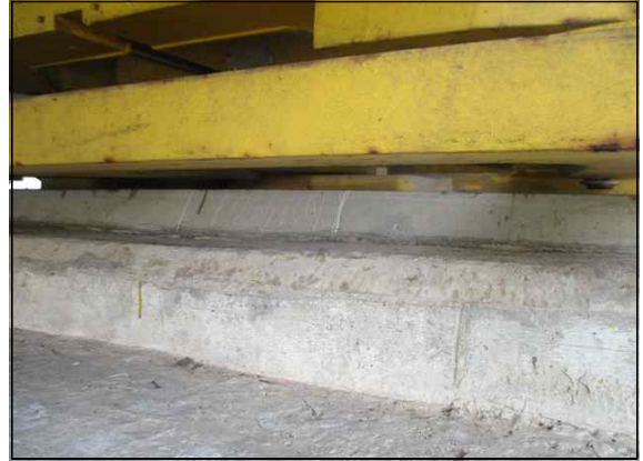
무수축물탈 균열(P7 SH1)
