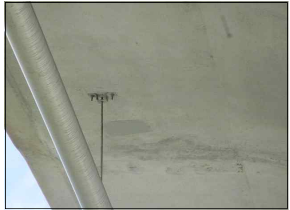
바닥판 파손보수 현황(S9)
