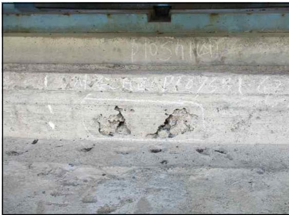
받침콘크리트 재료분리(P10 SH1)
