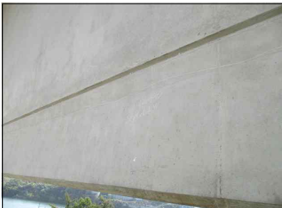
거더 외부 측면 균열(S8)
