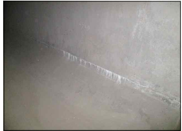
거더 내부 백태(S12)
