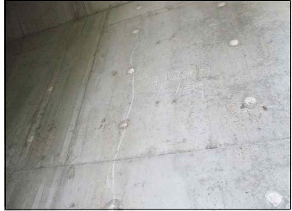
교대 흉벽 균열(A2)
