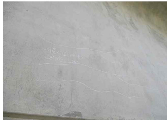
거더 외부 측면 균열(S10)
