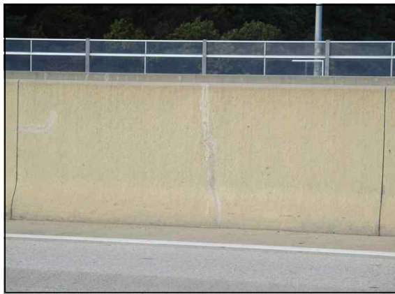
방호벽 균열부 백태(S3)
