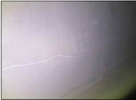
거더 내부 균열(S2)
